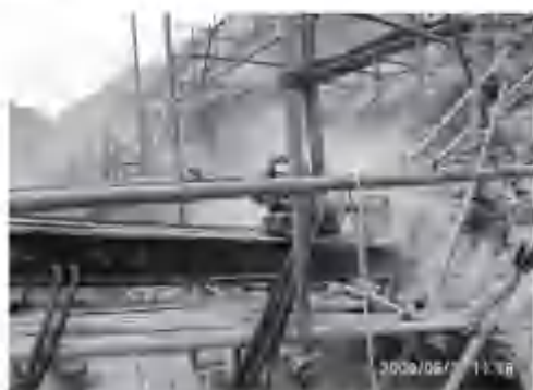
钻孔施工（角度、 长度、清孔、注浆 问题）
