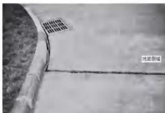
基坑开挖：道路开裂（影响地下管道安全）
