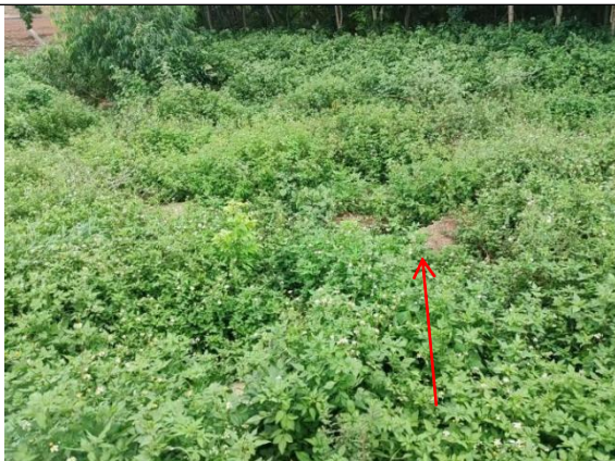
排水沟及检修井
