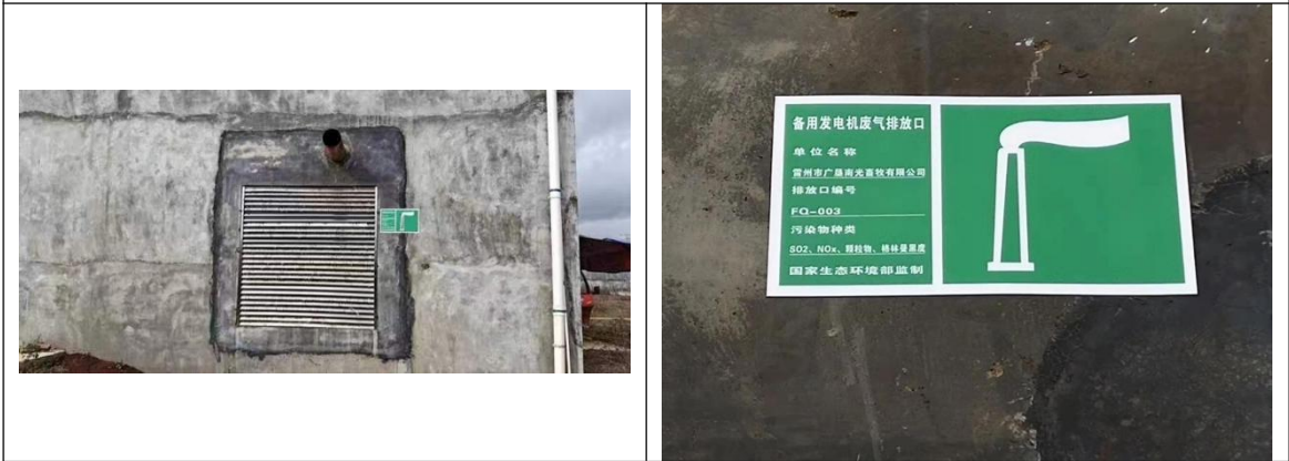
废气排放口标志牌设置图片（FQ-03）
