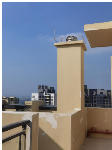
备用发电机尾气通过楼顶排放
