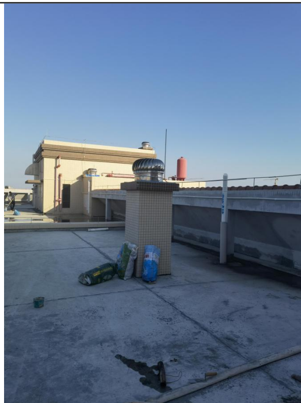
厨房烟气管道
