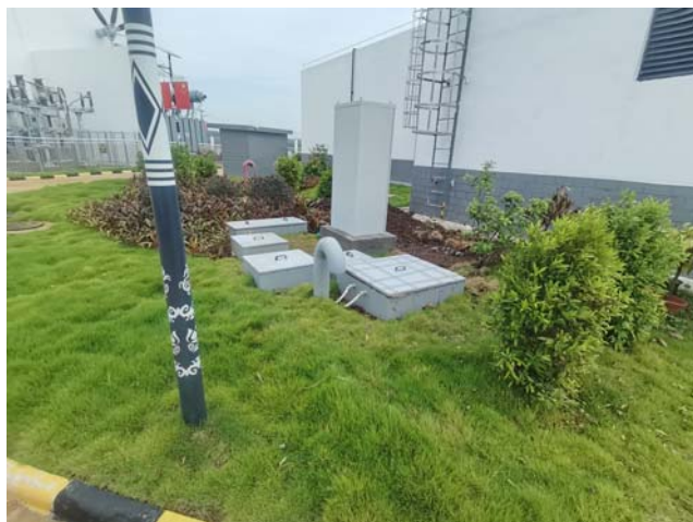
图6-9 污水处理设施
