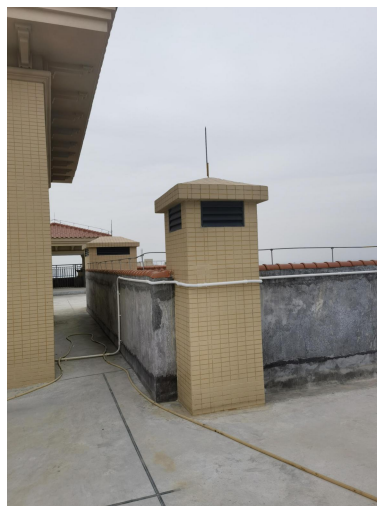
备用发电机尾气排放口
