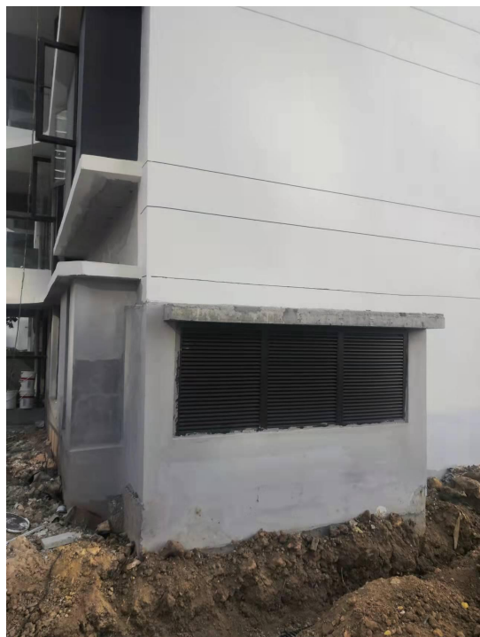
图 6-5 地下室排气口
