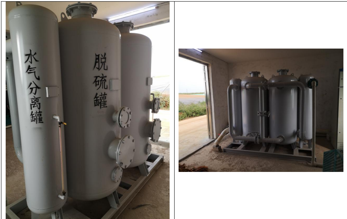
水气分离罐、脱硫罐
