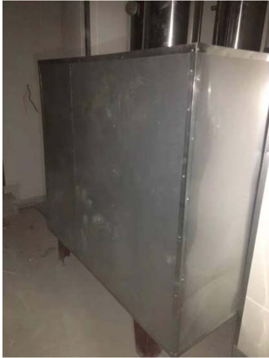
图 6-9 备用发电机水喷淋装置
