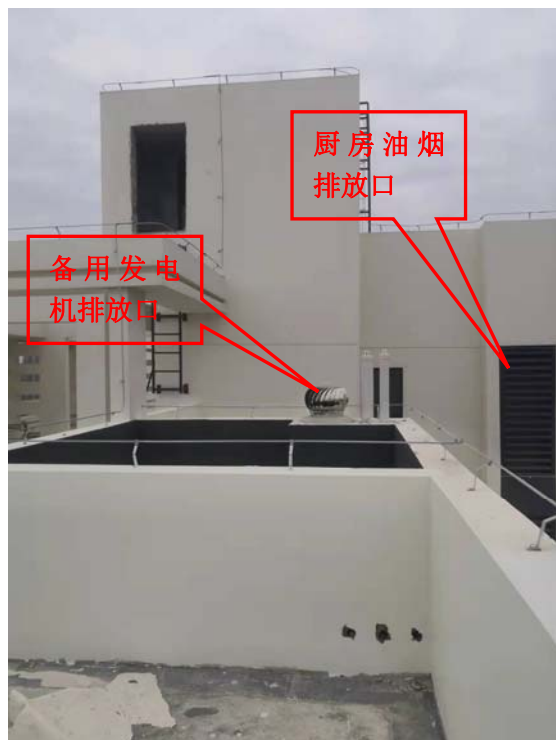
图 6-8 居民厨房油烟排放口及备用发电机排放口
