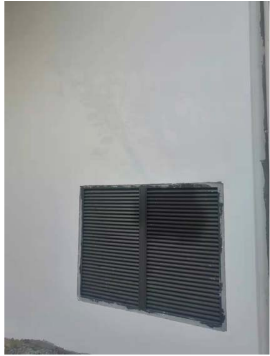
图 6-6 地下室排气口
