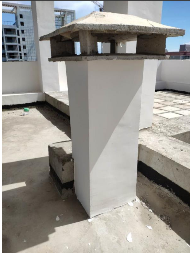
图6-9 居民厨房排烟口
