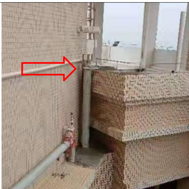
图6-15 备用发电机废气排放口
