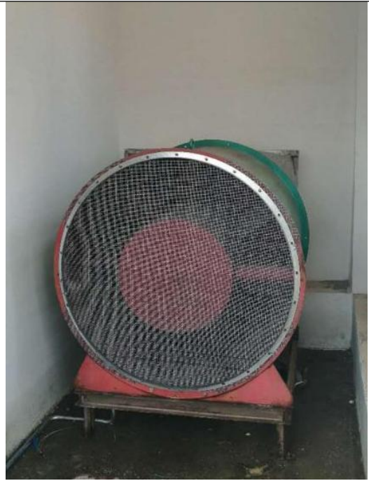
图6-10 楼顶电梯房风机
