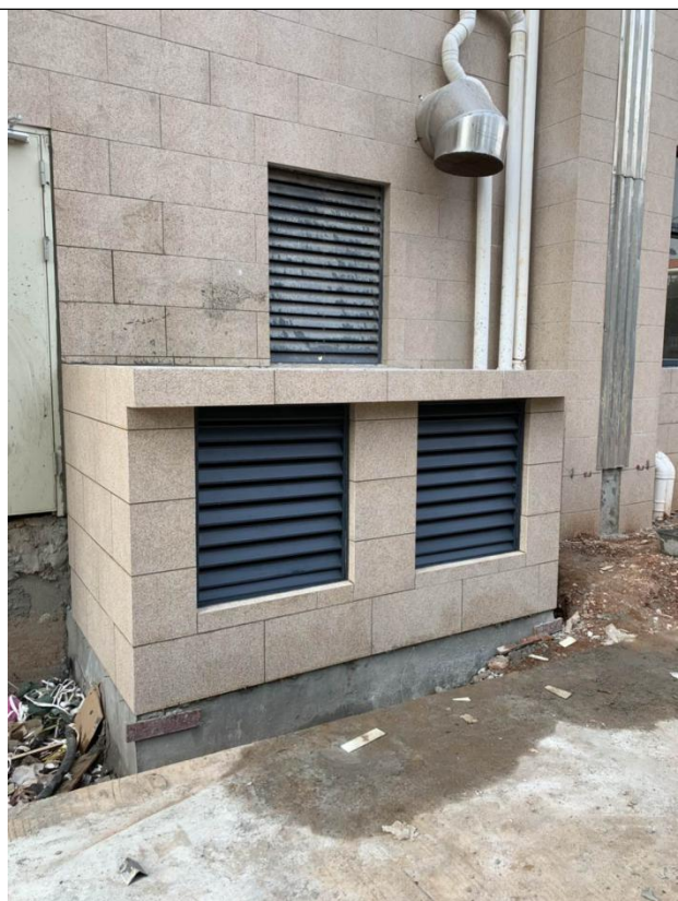
图6-7 项目地下室换气口
