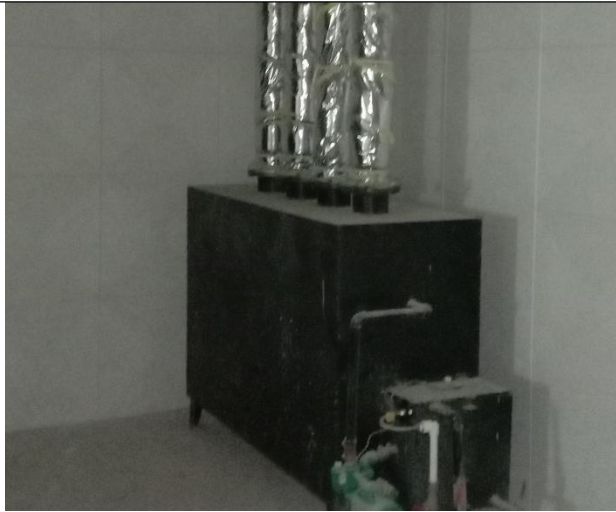
图6-13 备用发电机水喷淋装置
