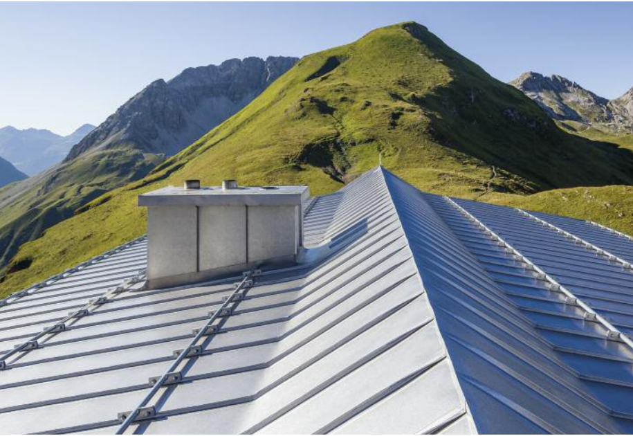
不锈钢立缝屋顶采用双锁技术实现永久性密封，以适应山区大风、大雪和极端温度等恶劣环境。 © Roofinox
