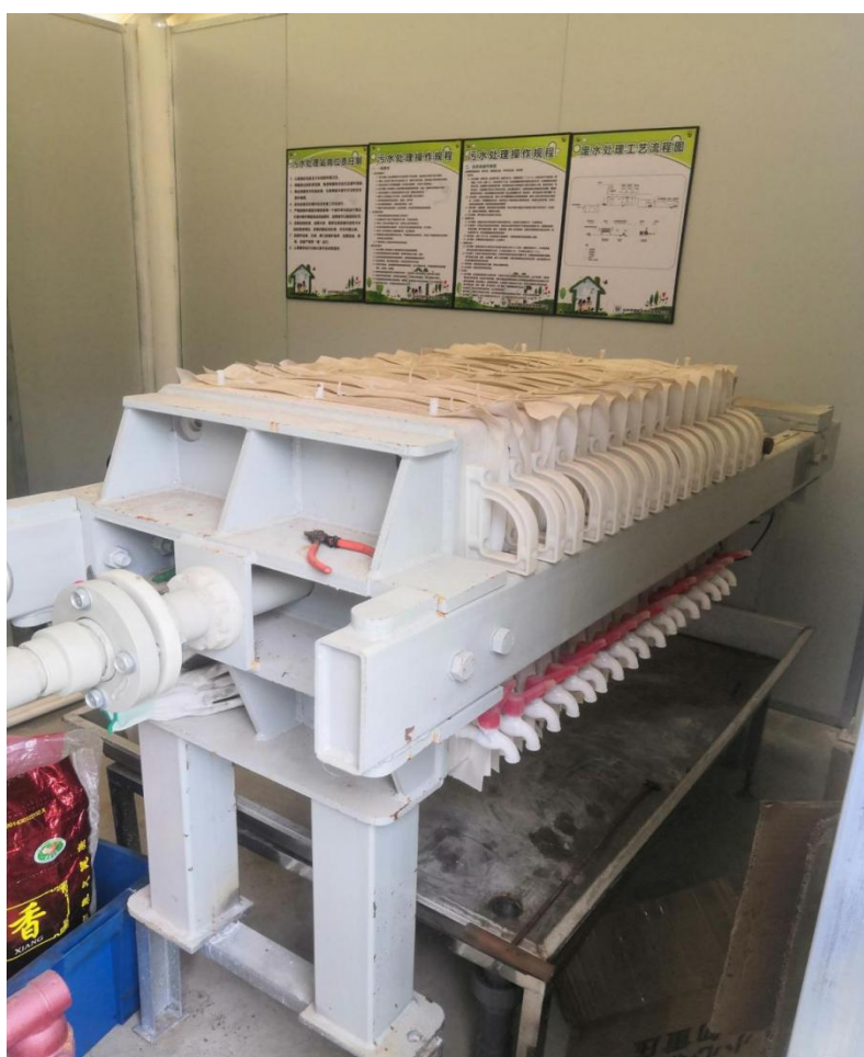
废水站压滤机
