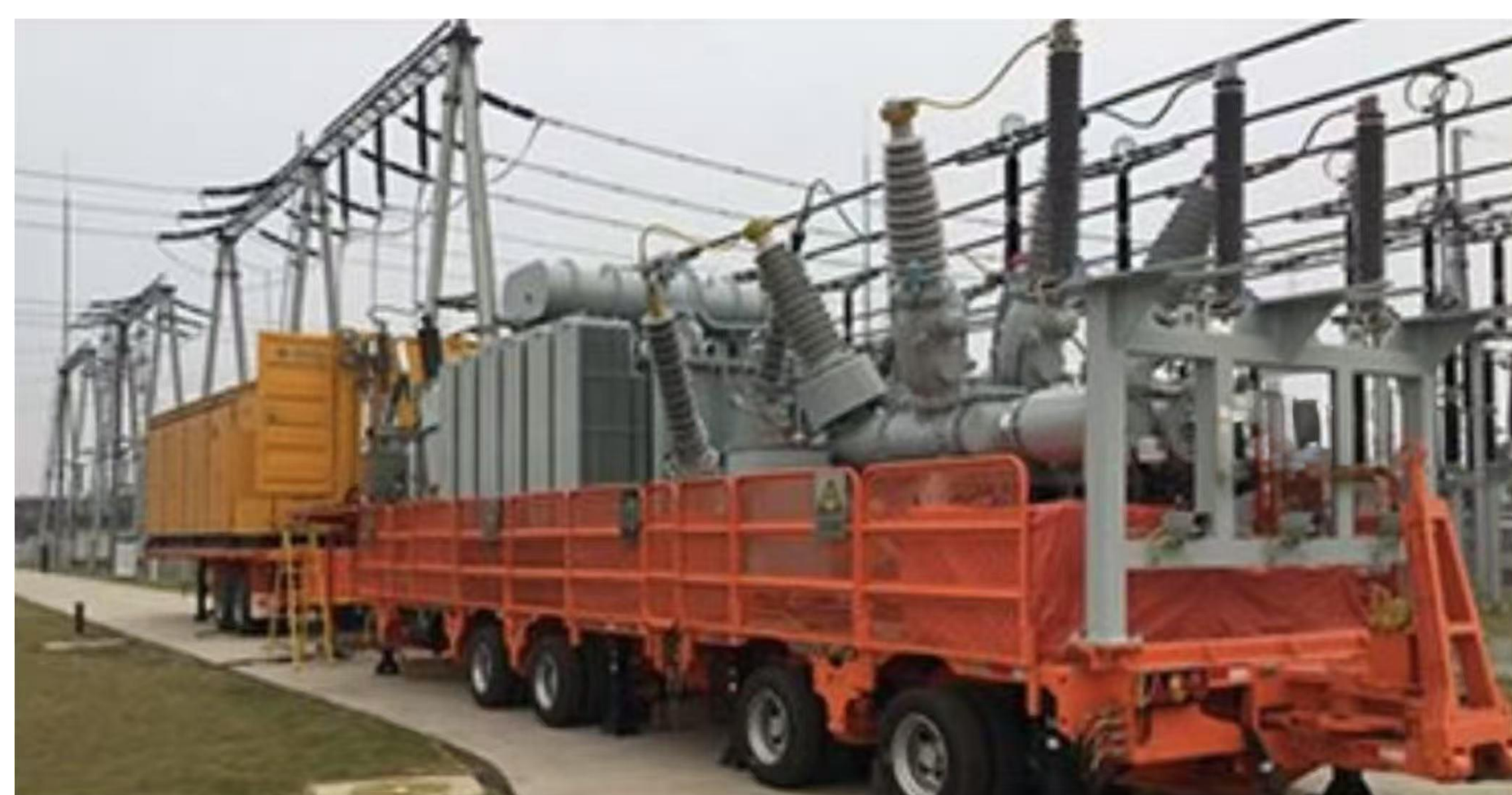
Trạm biến áp lưu động dùng GIS truyền thống
