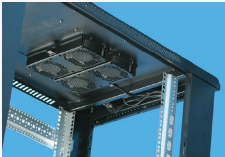
安装后机柜内部图
