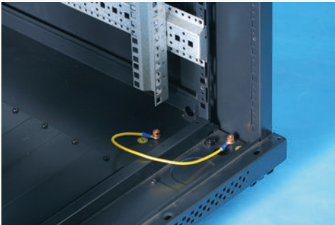
可用接地线将机柜连成一个整体
