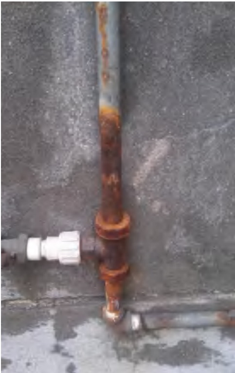
给水管道腐蚀影响饮水安全
