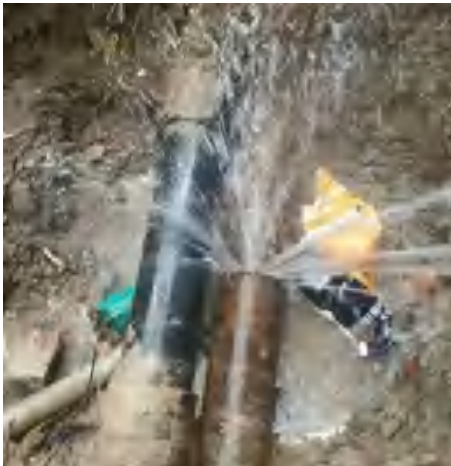
给水管道腐蚀：漏水
