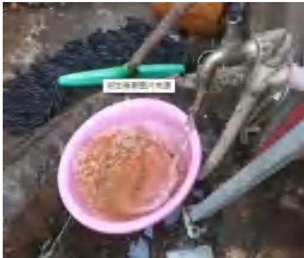
给水管道腐蚀：用水安全隐患
