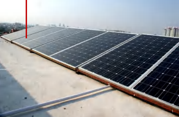
平屋面采用太阳能光伏板
