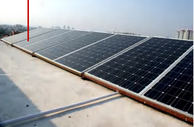
平屋面采用太阳能光伏板
