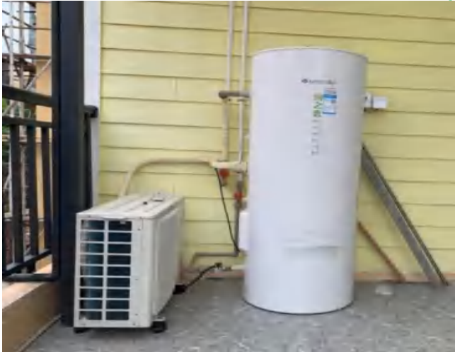
空气源热泵热水系统
