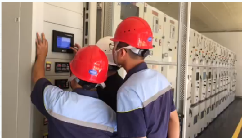
现场电气维护人员操作学习
