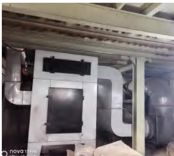
投料、混料袋式除尘器
