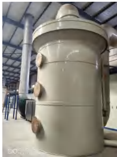
4#水喷淋+二级活性炭吸附装置及其排气筒
