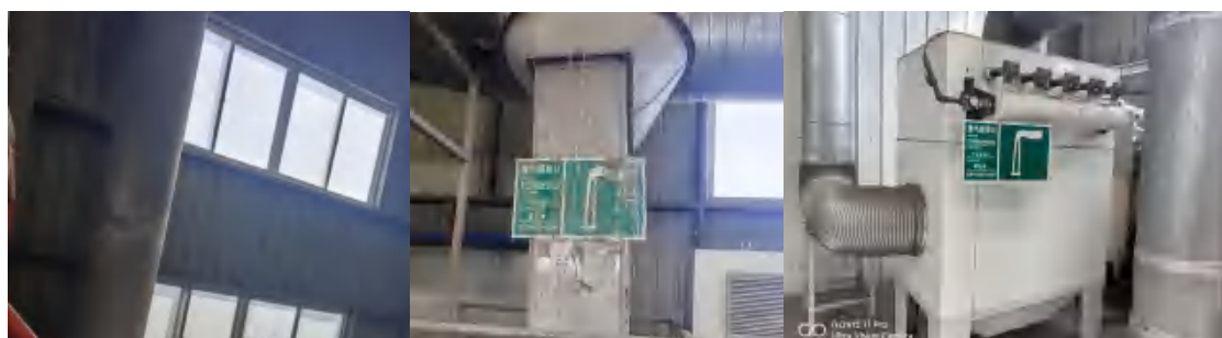
聚酯生产线采样口、标识牌
