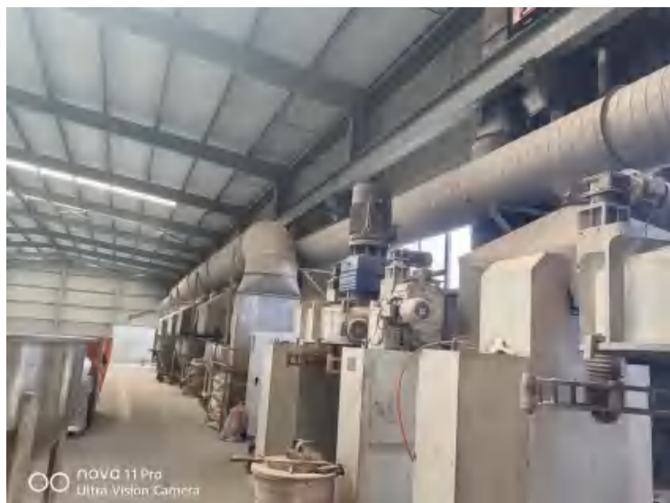
1-4#投料及混料集气罩及集尘管道
