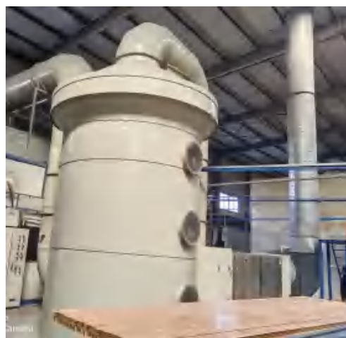
2#水喷淋+二级活性炭吸附装置及其排气筒
