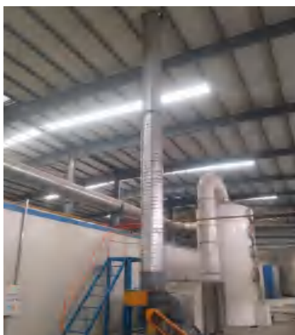
1#水喷淋+二级活性炭吸附装置及其排气筒
