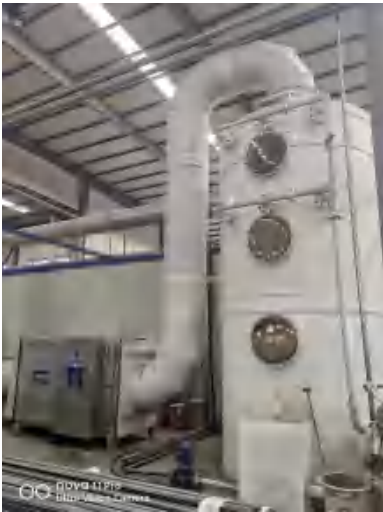
水喷淋+两级活性炭装置
