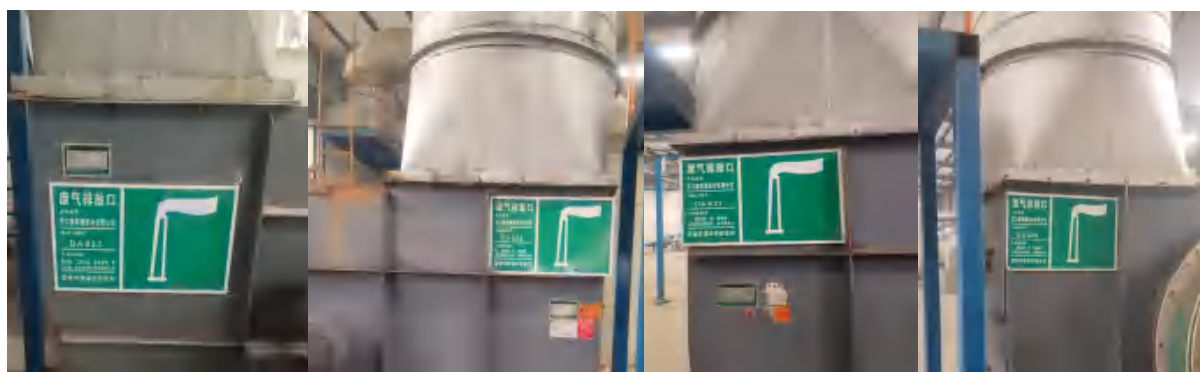
1-4#喷涂生产线采样口、标识牌
