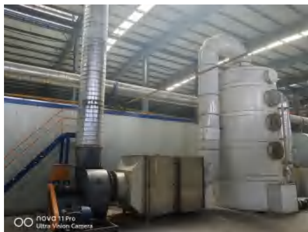
喷漆固化水喷淋+二级活性炭吸附装置及其排气筒
