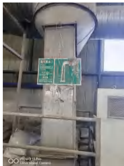
投料、混料排气筒
