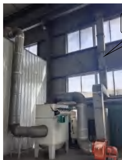
5#磨机袋式除尘器及其排气筒
