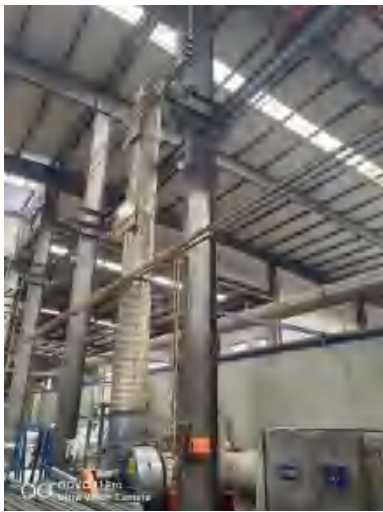
静电喷涂固化炉排气筒
