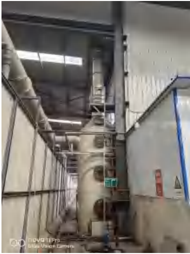
前处理碱液喷淋塔及其排气筒
