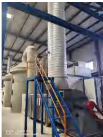
3#水喷淋+二级活性炭吸附装置及其排气筒
