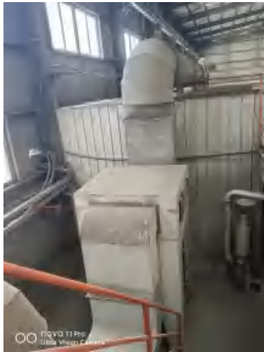
1-4#磨机袋式除尘器及其收尘管道
