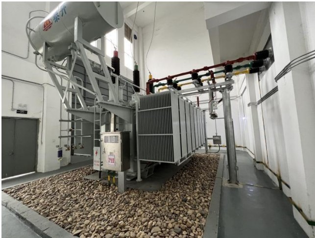
2#主变及下方事故油坑
