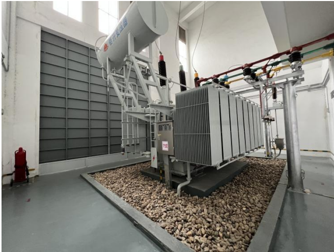
1#主变及下方事故油坑
