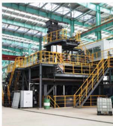
12吨真空感应炉
