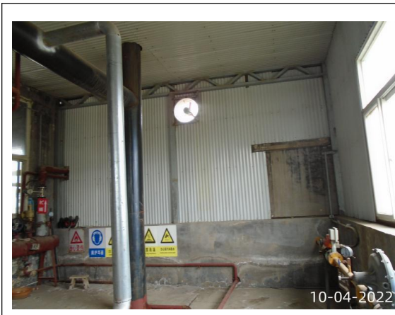
锅炉房轴流风机
