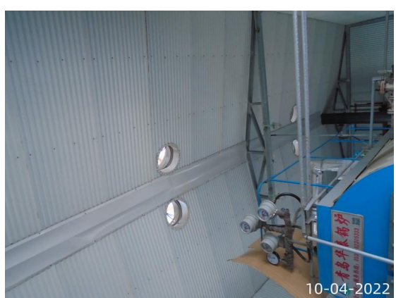
锅炉房无动力风机
