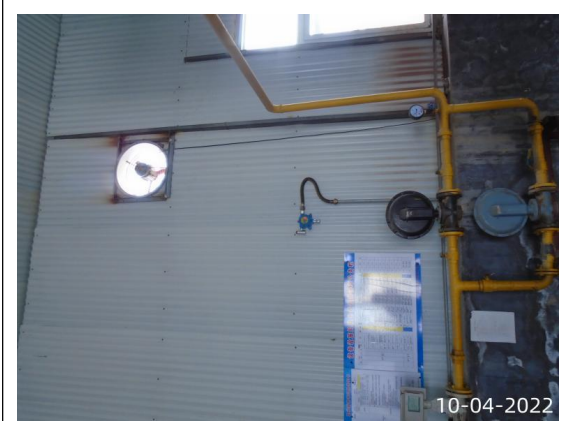
锅炉房轴流风机
