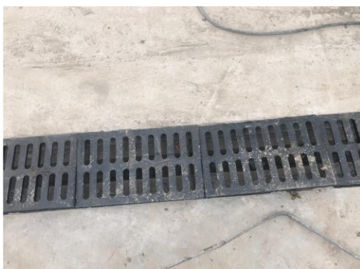
EW 七路临时排水沟
