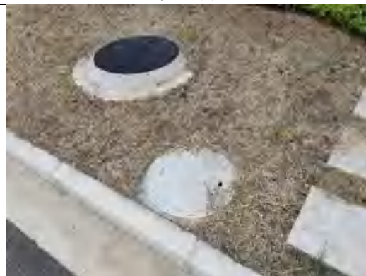
雨水排水管线
