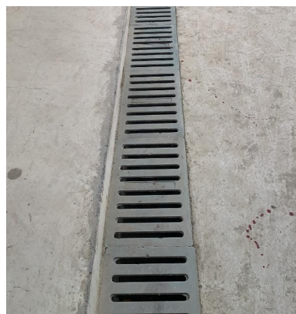
临时排水沟（办公区）
