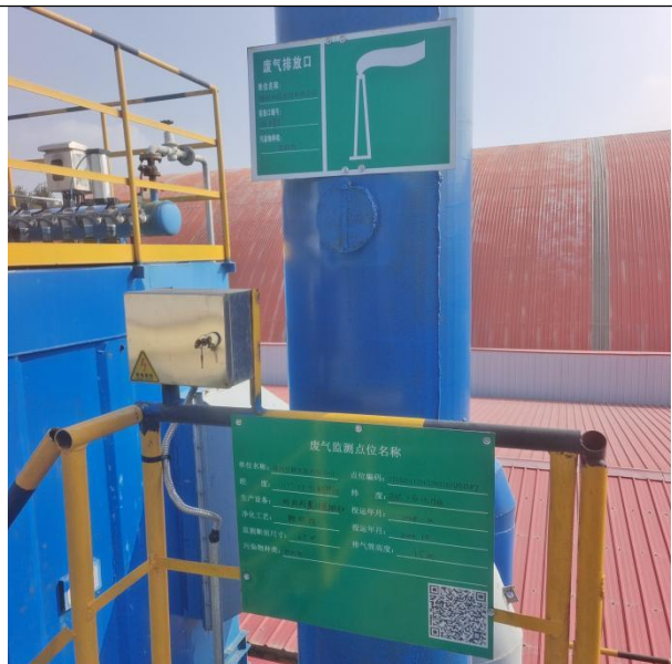
上料排放口与检测平台
