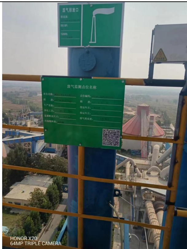
计量排放口与检测平台
