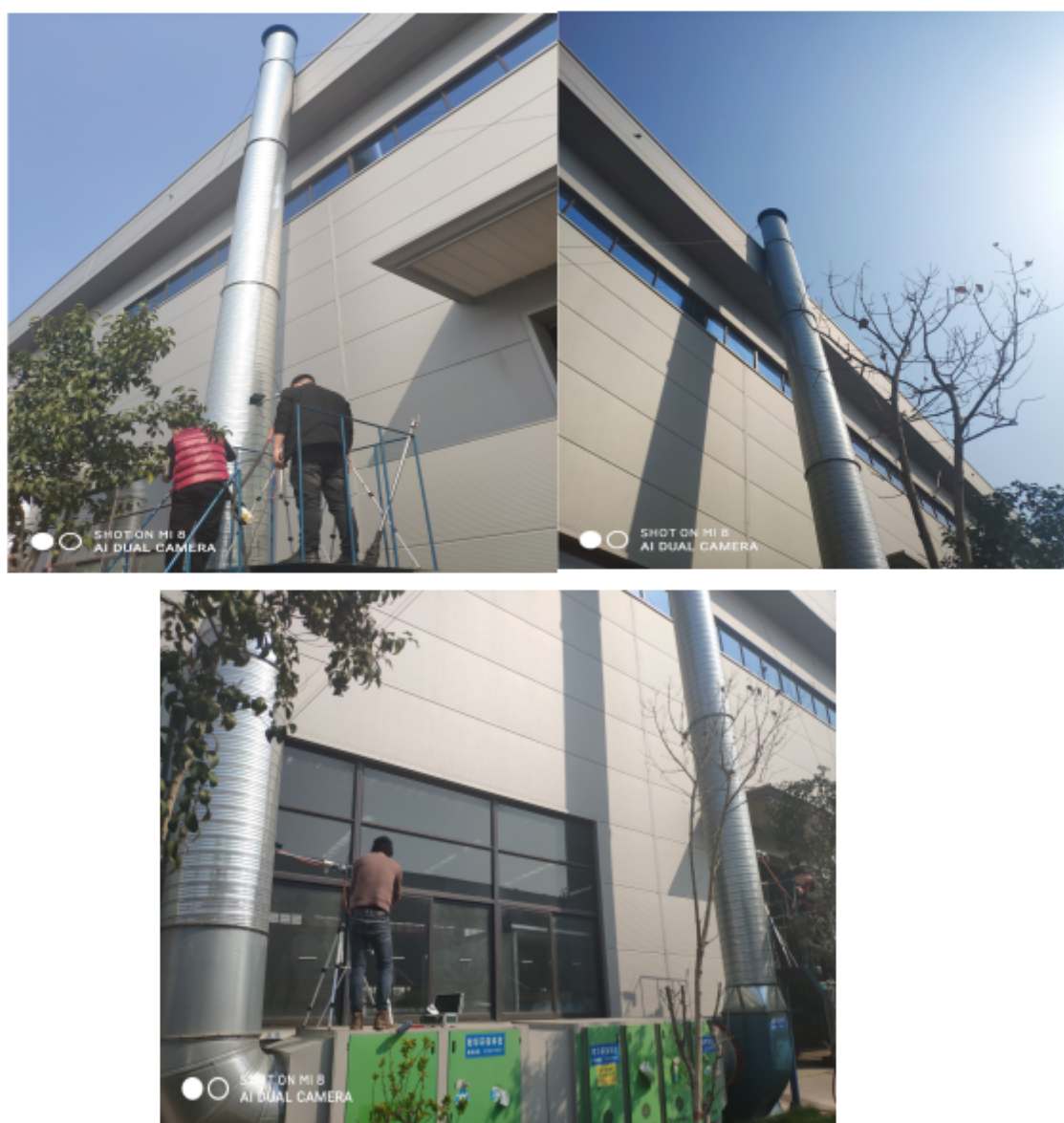
V 型滤纸+过滤棉+高密度纤维过滤网” + UV 光氧催化+活性炭吸附装置
