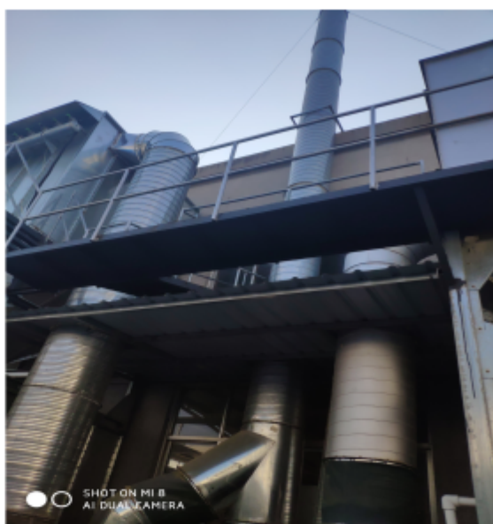
家具喷漆室废气处理措施
