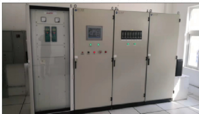
深圳燃气龙华调压站
