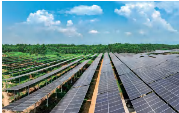
桂冠电力港北庆丰光伏发电项目
