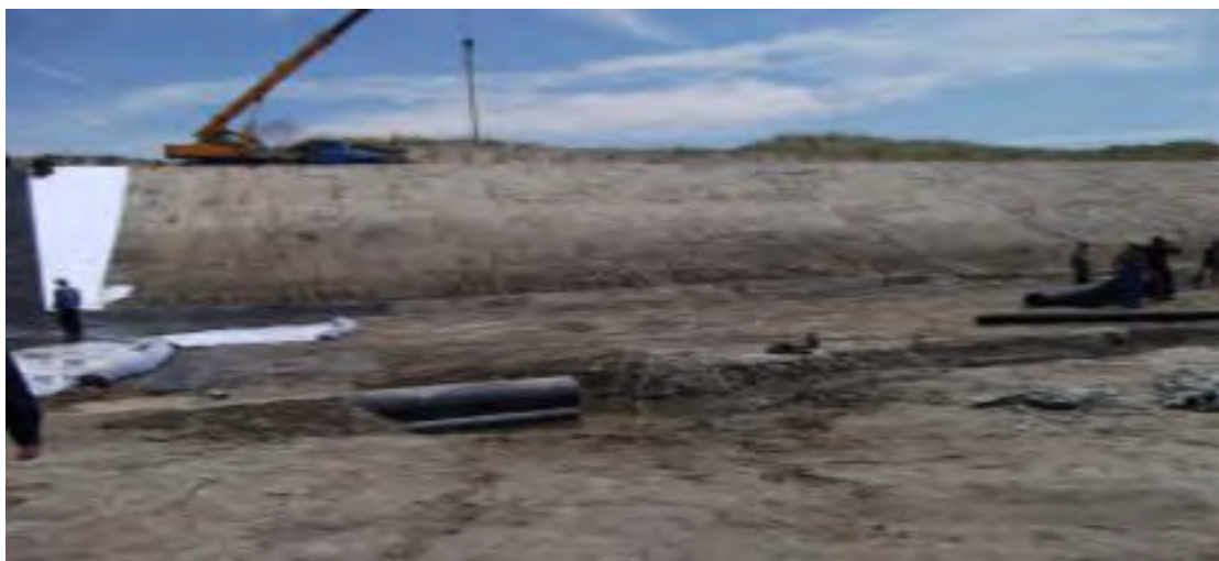
图 4-11 渗滤液排水管
