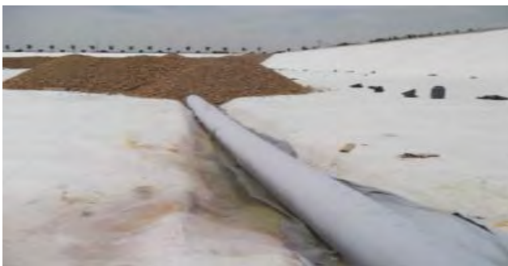
图 4-8 主渗滤液收集管
