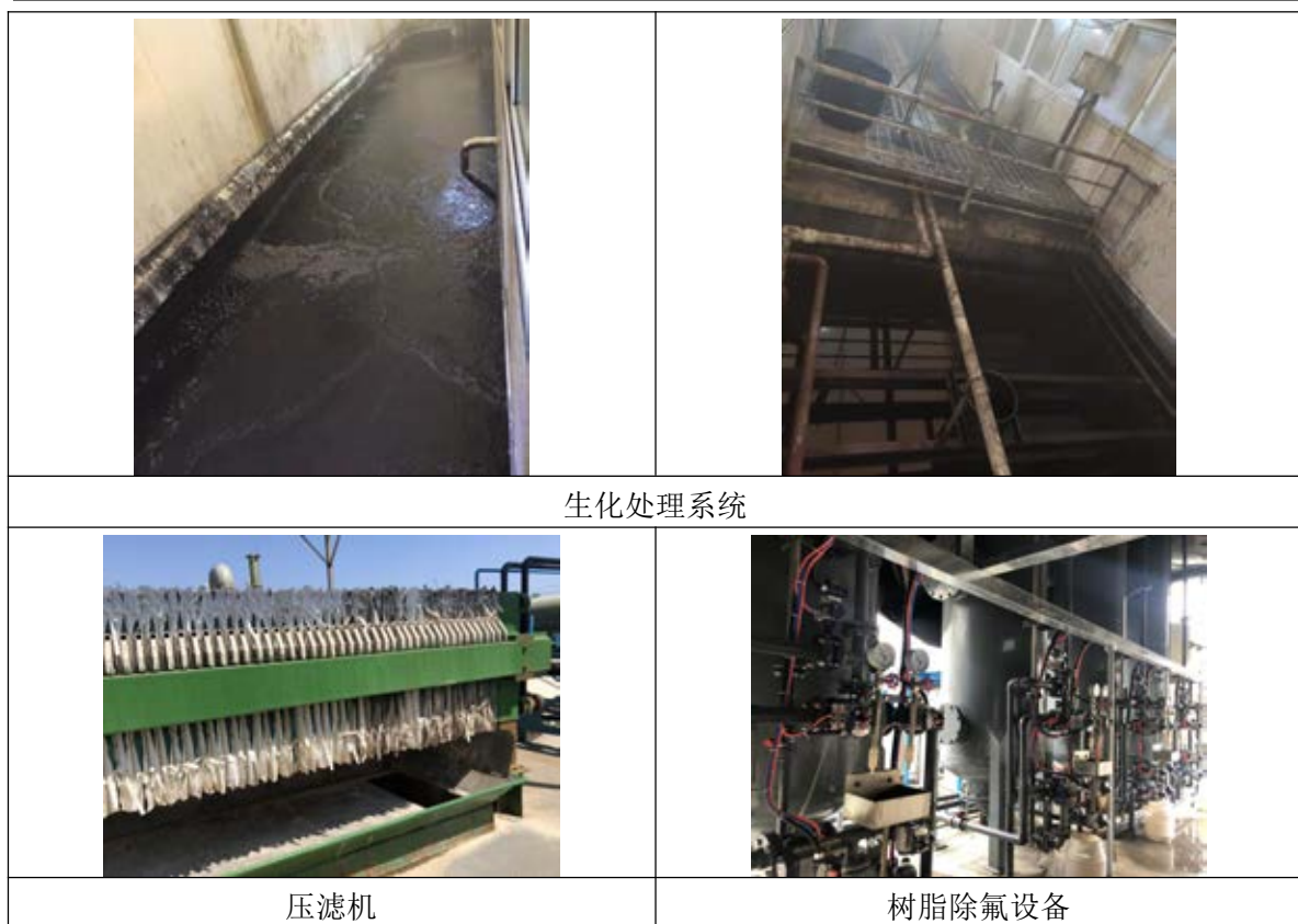
图 4.1-3 污水处理设施照片
