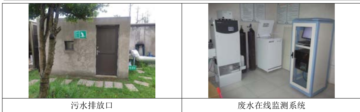
图 4.2-3 企业污水排放口及在线监测系统
