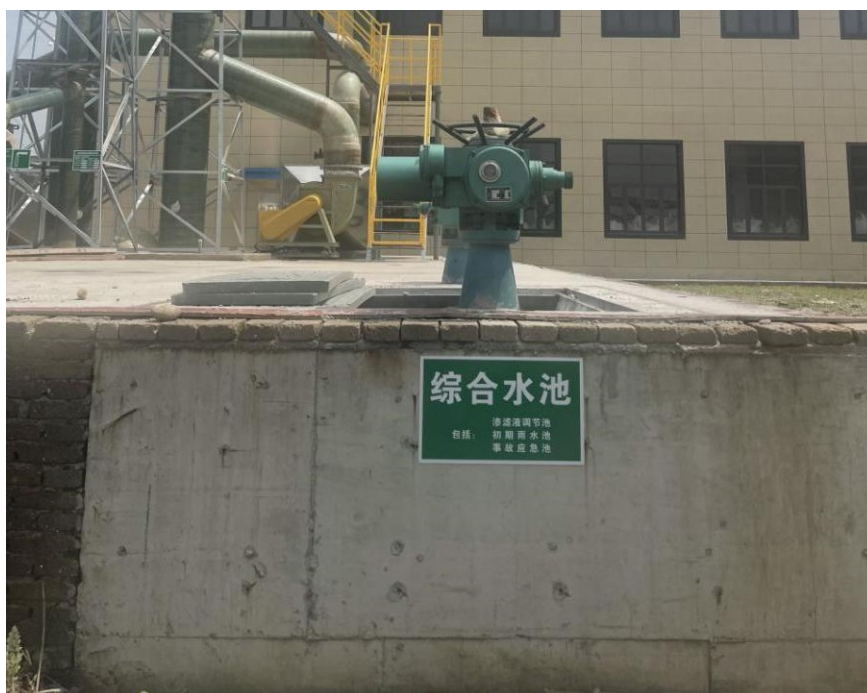
图 4.2-1 综合水池（包括渗滤液调节池、初期雨水池、事故应急池）
