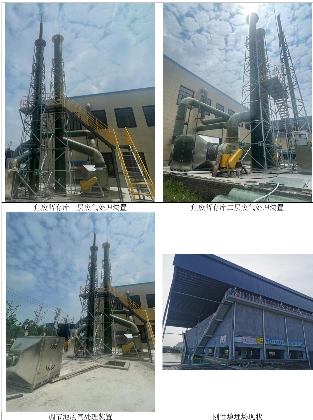
图 4.1-4 废气处理设施照片
