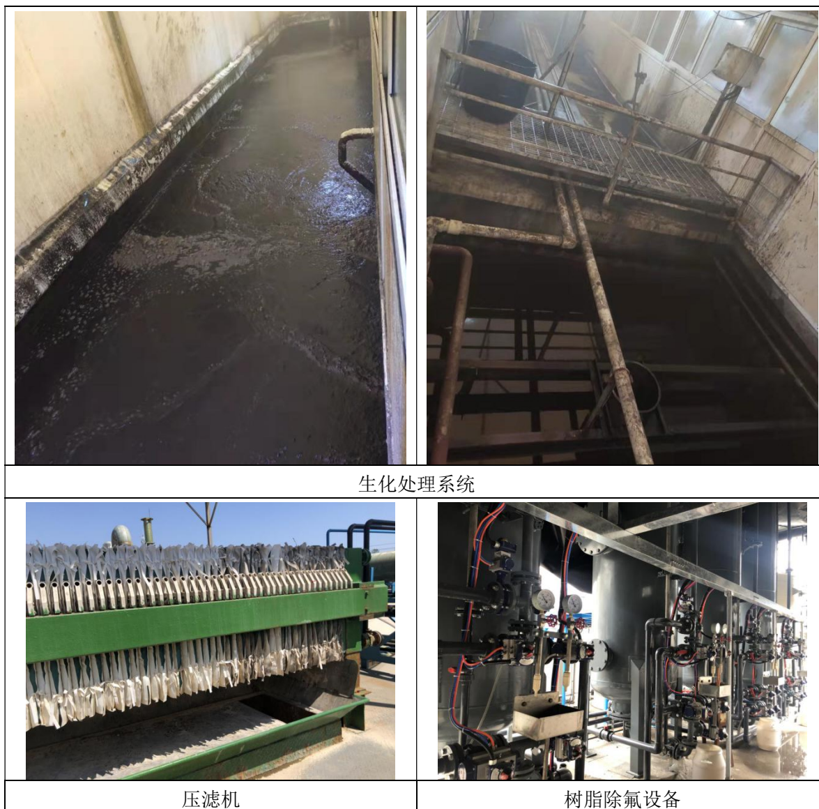
图 4.1-3 污水处理设施照片
