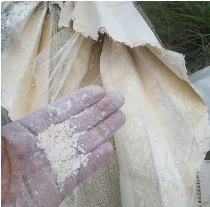
混盐DTRO保安过滤器滤芯污堵。
