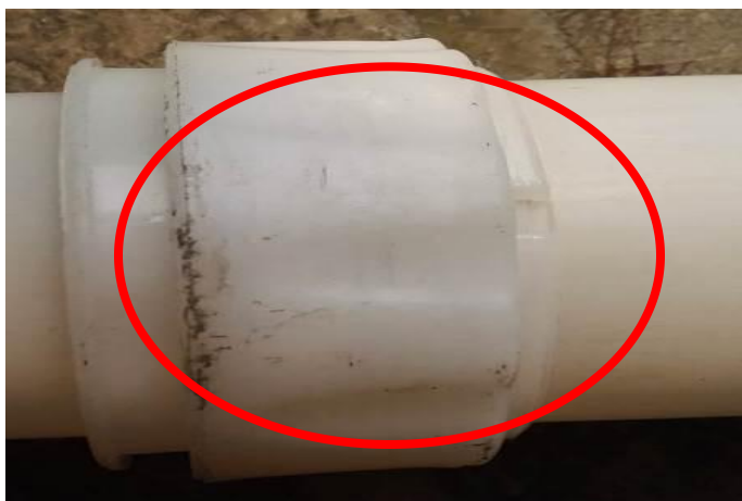
新管托帽安装部位管身加有止退槽
