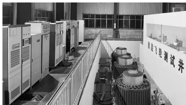
图 17 500 kW-125 kW·h 磁悬浮储能飞轮测试现场
