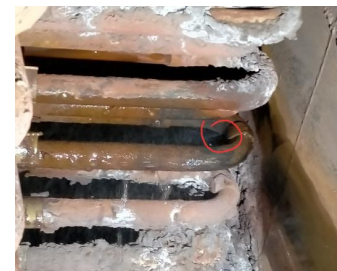
省煤器管排弯 头腐蚀泄漏
