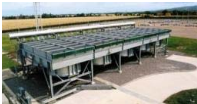
机械通风间冷系统MDCT
