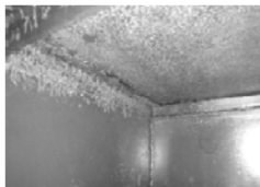
油箱顶部锈蚀产物
