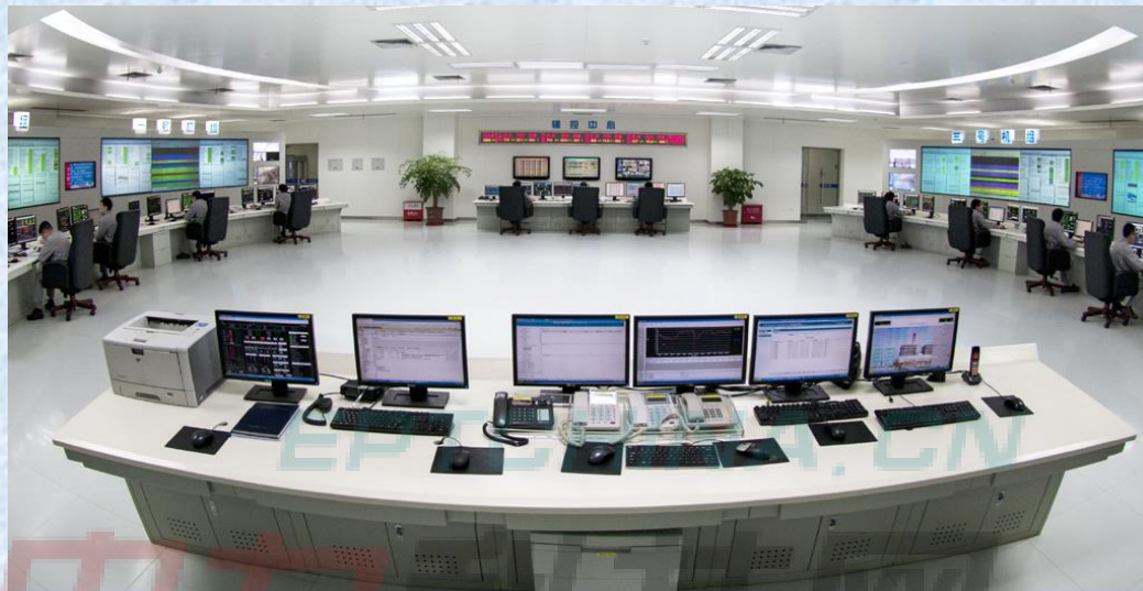
海门电厂集控室（四机一控）
