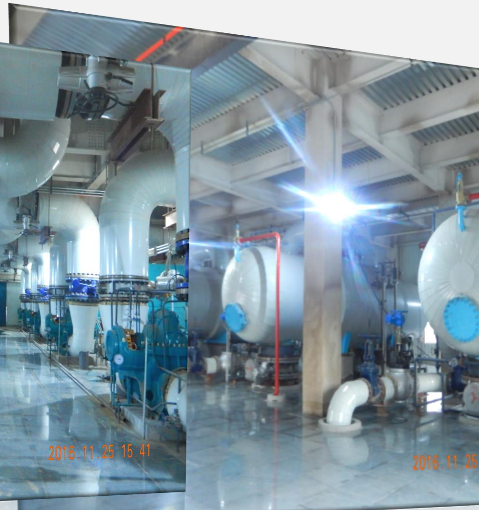
太原供热首站尖峰加热蒸汽间
