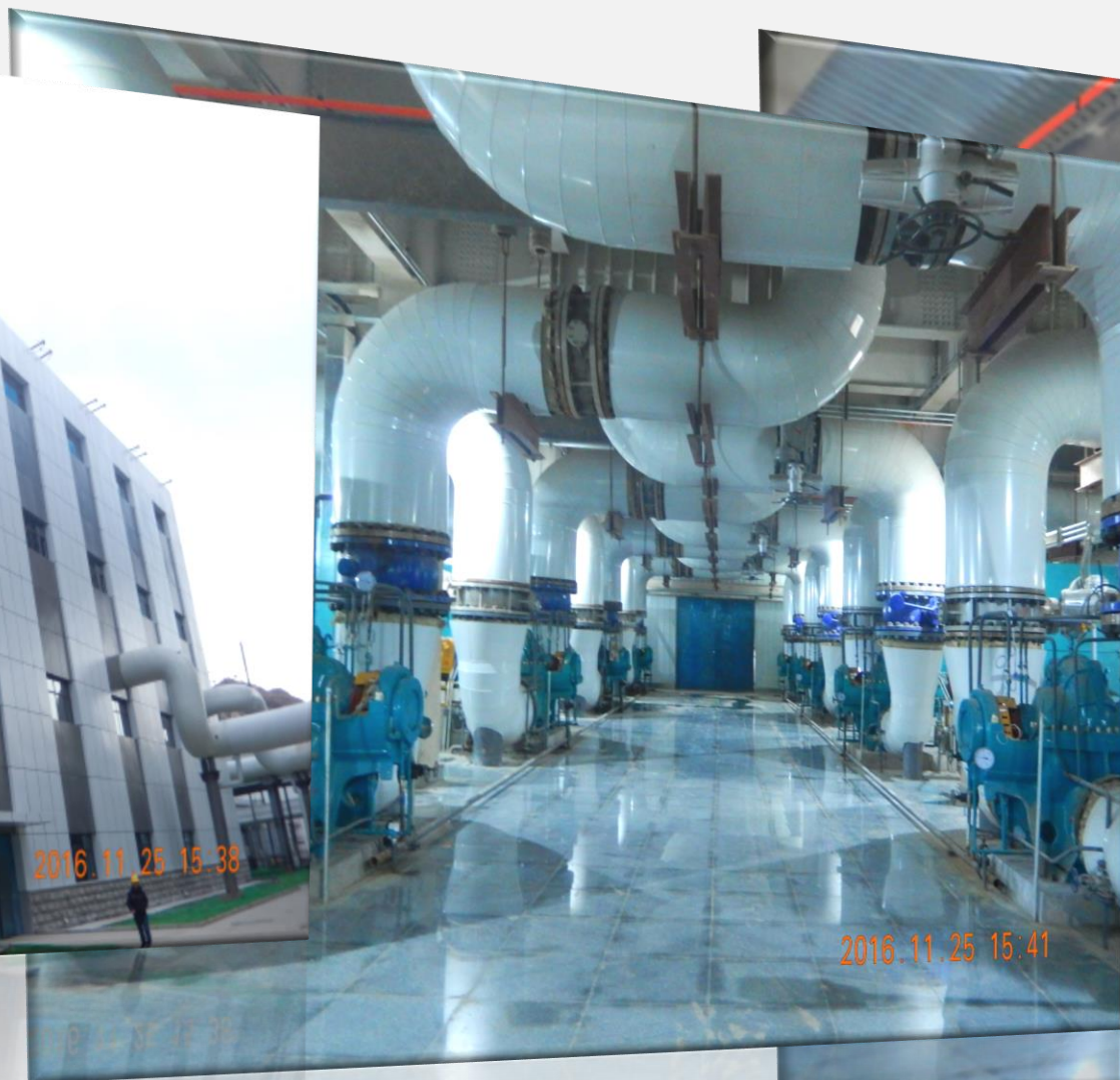
太原供热首站循环水泵间
