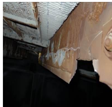
密封片部分腐蚀
