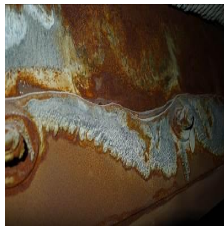
钢结构部分腐蚀
