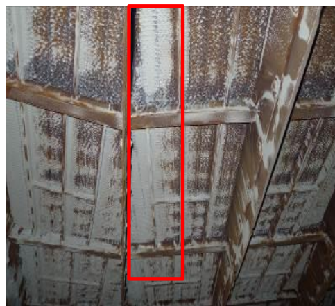
径向密封片外侧堵塞严重
