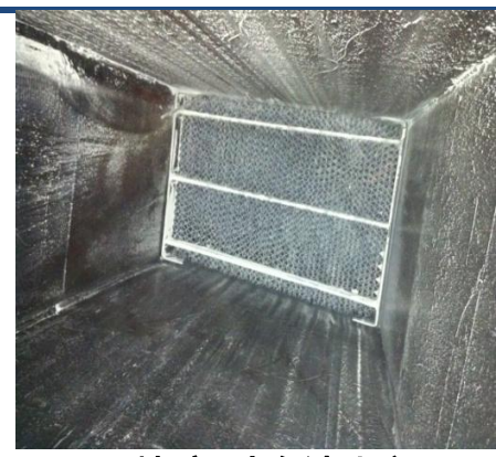
堵塞到冷端上部
