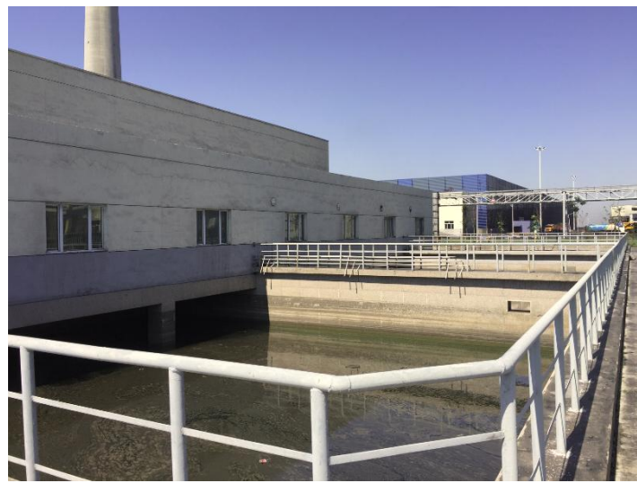
HTB事故水池
