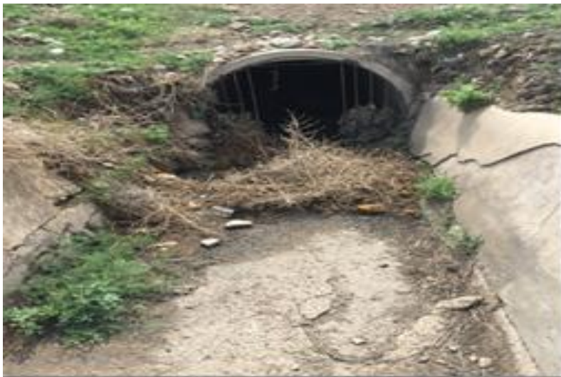
YG事故排水口
