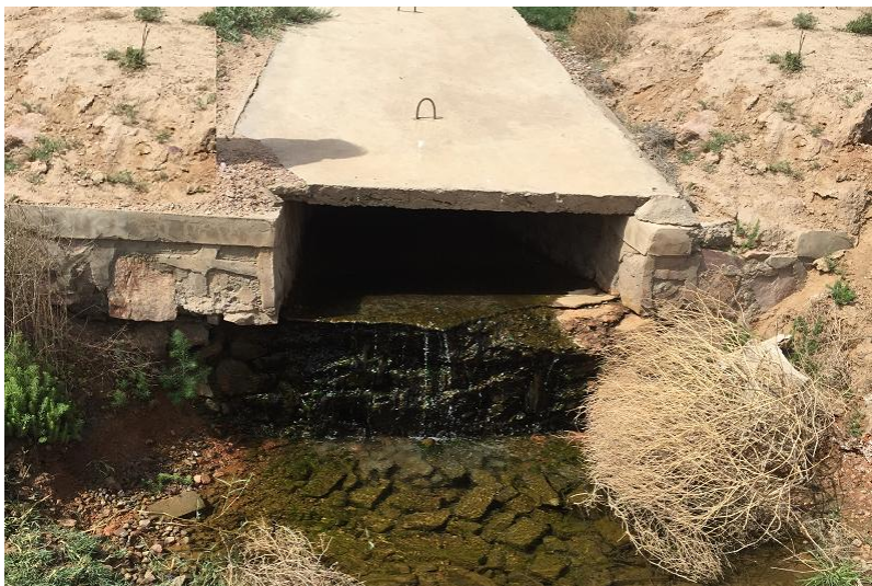
JT事故排水口
