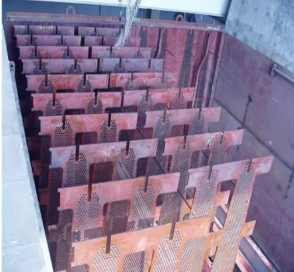
图11-3 凝汽器冷却水中间管板
