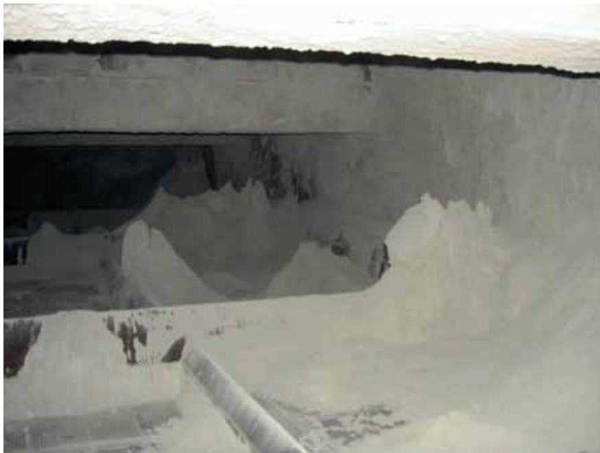
图 1 流场不均导致积灰严重
