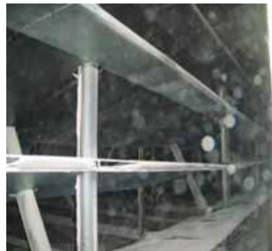
图 5 入口导流板磨损
