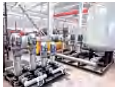
直连加压供水设备
