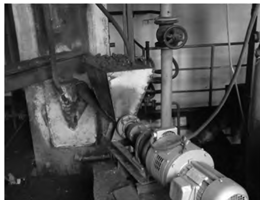
改造后的1MW a CFB试验台螺旋式给料系统
