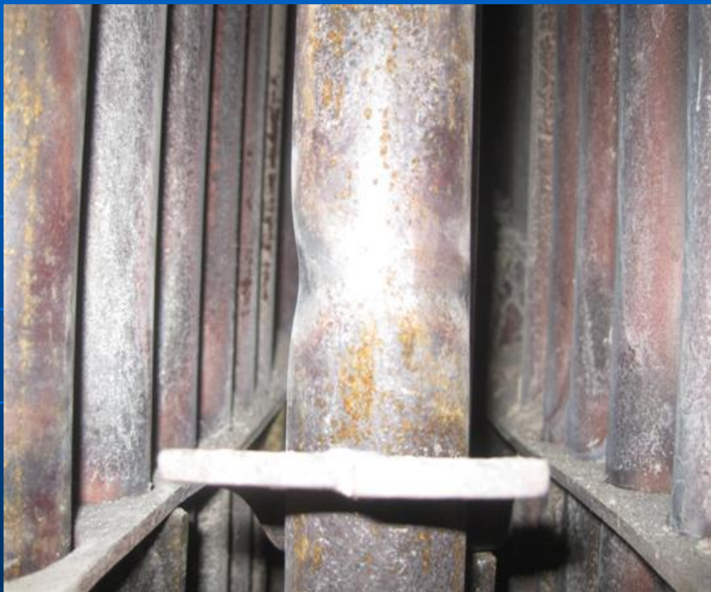
高再管屏管卡对管子造成磨损
