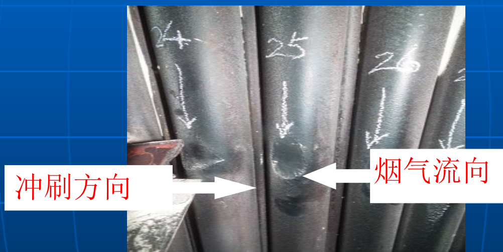
包覆过热器侧墙管冲刷减薄严重
