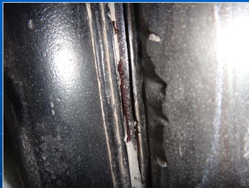
冷灰斗处水冷壁减薄严重
