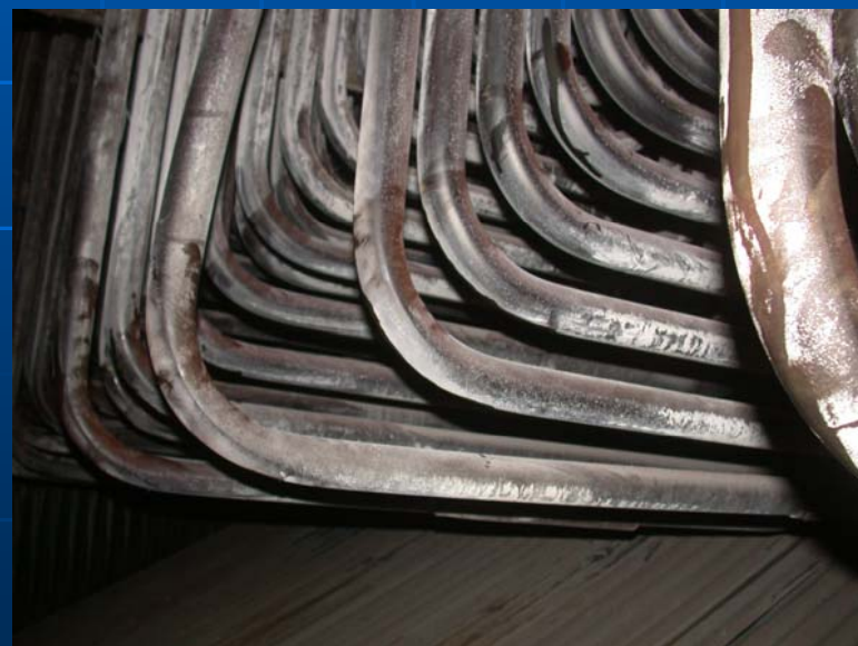
过热器管排弯管处吹损形貌
