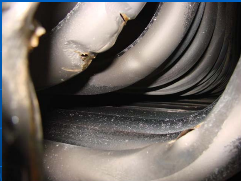
水平低温过热器弯头磨损爆口
