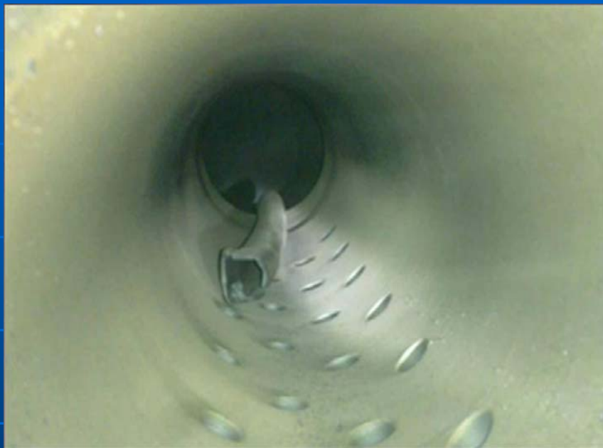
对应高温再热器入口联箱内遗留钢管堵塞管口
