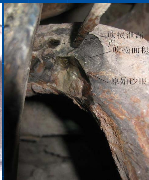
省煤器管原始砂眼泄漏
