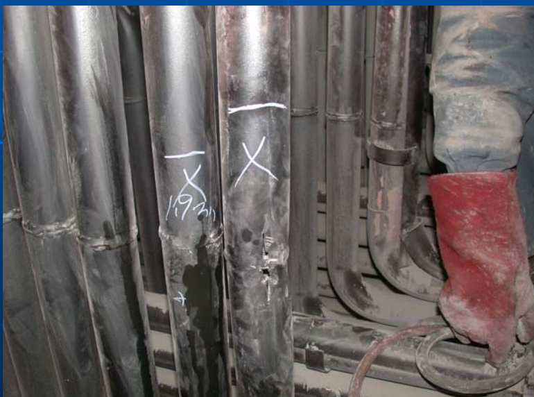
再热器吹灰器区域管排防磨瓦脱落管子吹损
