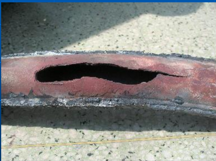
锅炉水冷壁管子氢脆爆口
