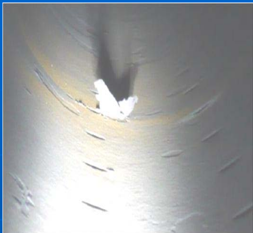
异物堵塞屏式过热器管孔
