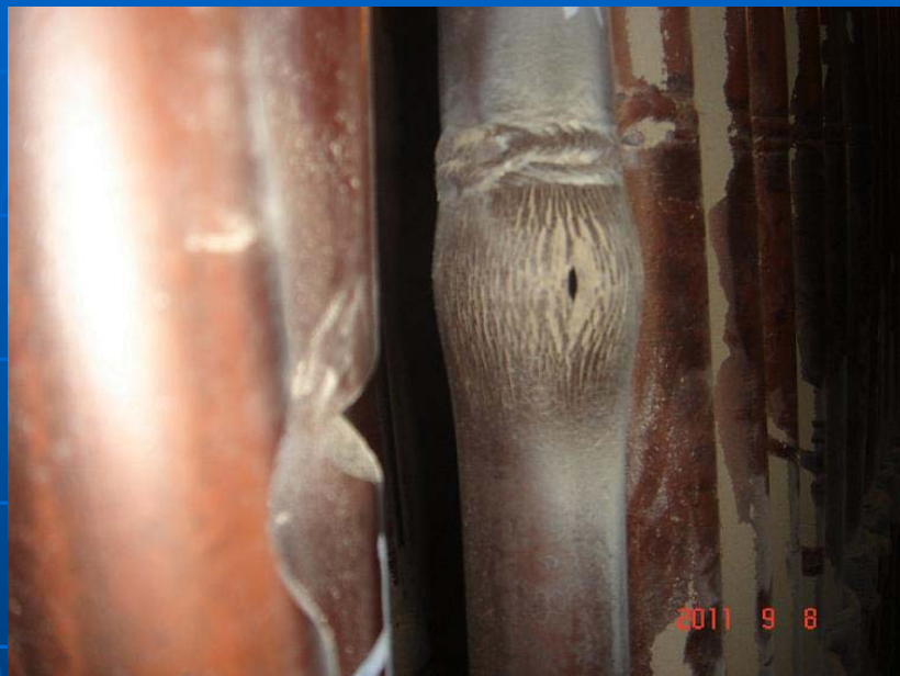
高温过热器T91材料氧化皮脱落爆管宏观图
