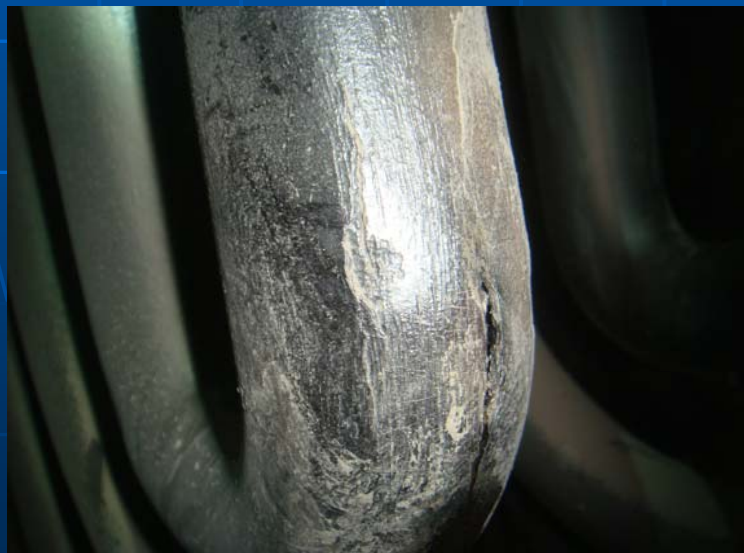
钢研102材料氧化皮脱落爆管
