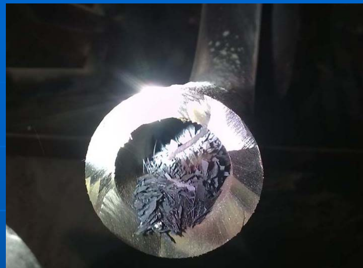
TP347H材料氧化皮脱落在出口弯头处堆积
