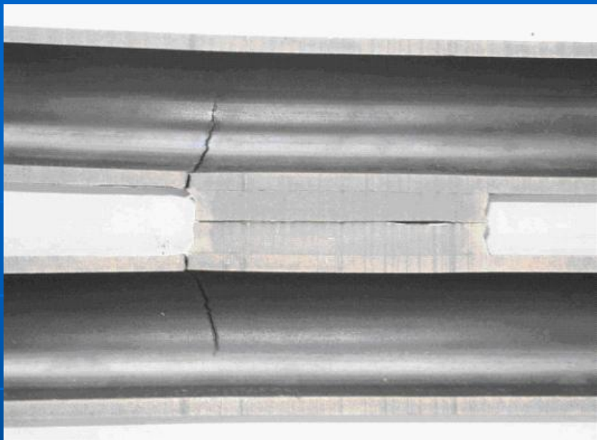
← 后屏过热器穿墙管定位块处裂纹泄漏
