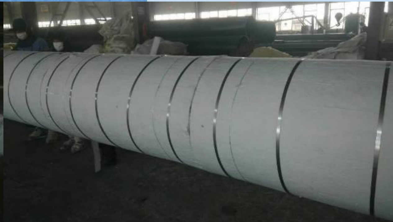
地埋管芯管保温
