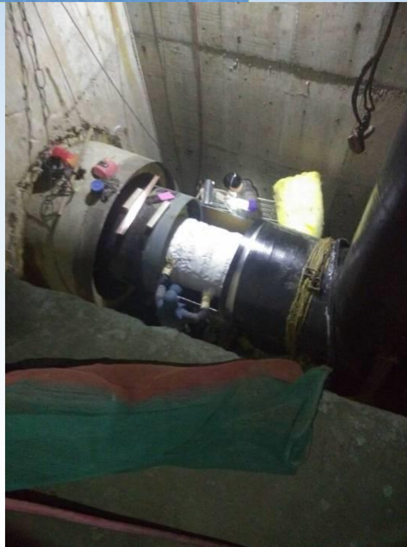
地埋管芯管保温
