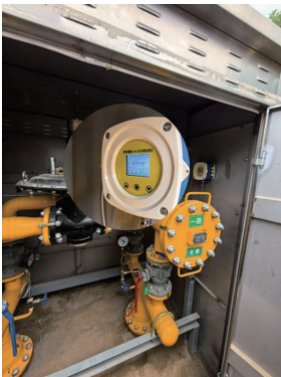
某中压力站检测
