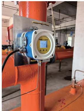
某高压力站检测
